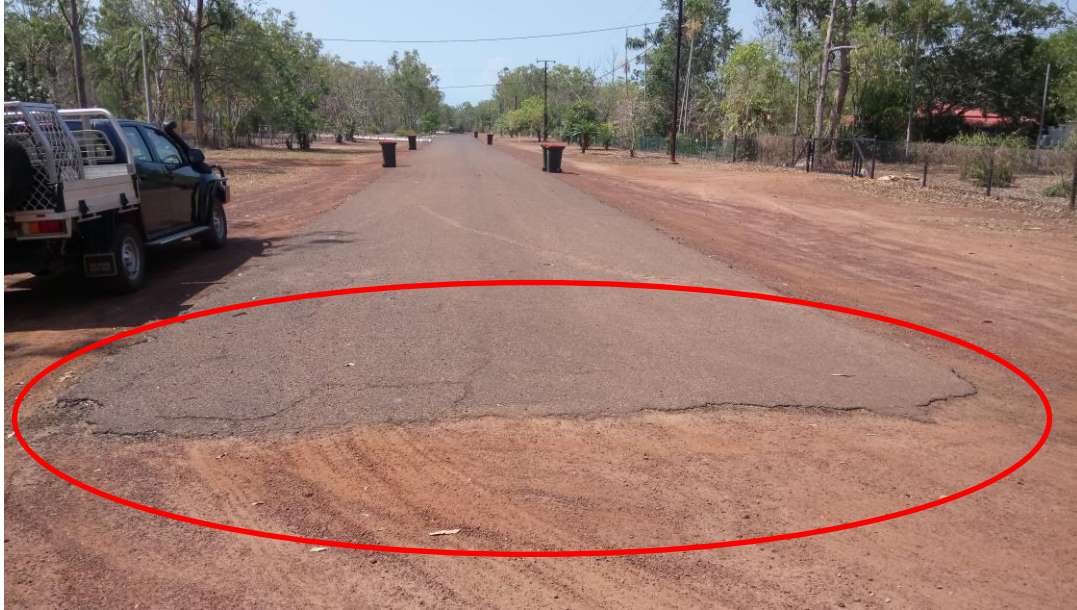
Edge break at CH0.0
